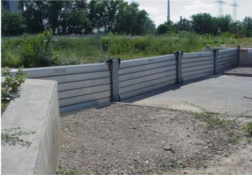
Dammbalkenverschluss mit Mittelstützen
